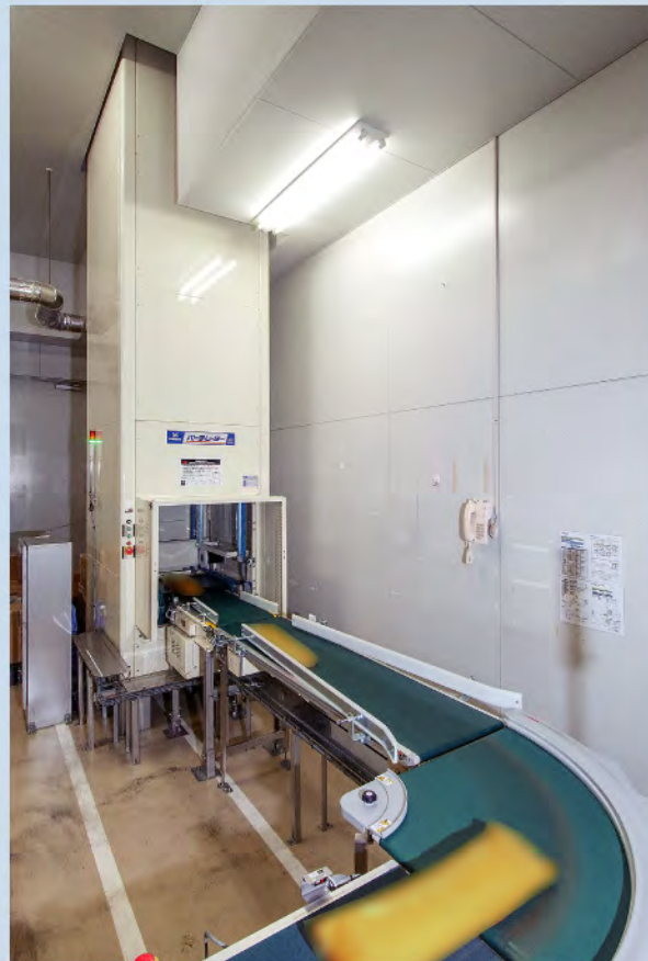
食品生产工厂【袋装物】/ 带式Ventilator
