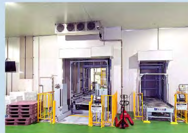
低温倉庫(プラスチックパレット) ※上部階天井吊りリモコンスイッチ仕様
