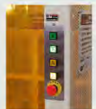
操作パネル(非常停止ボタン付)
