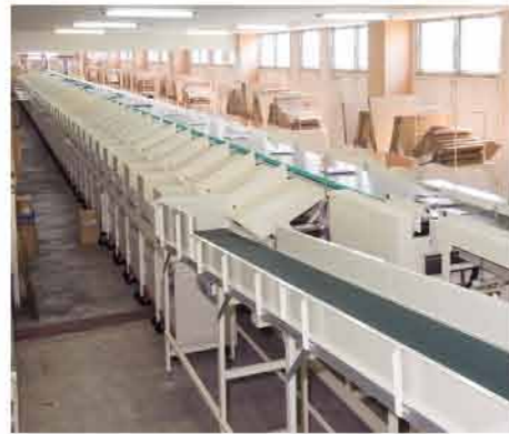
리젝트 물품 투입 에리어 반송 컨베이어
