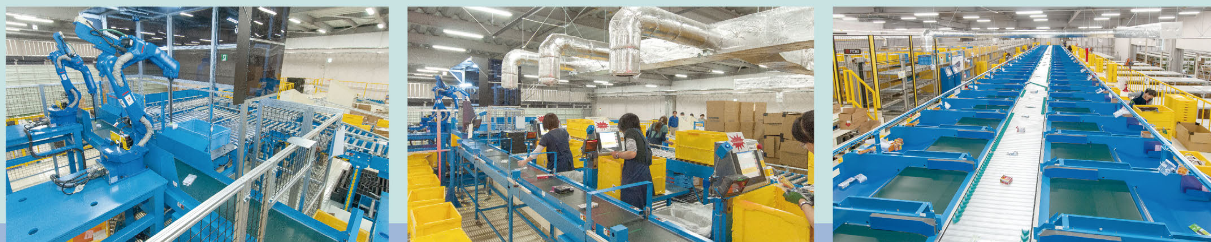
〈PAS納入事例〉OA機器・サプライ品物流センター／ロボット自動投入システムPAS I
